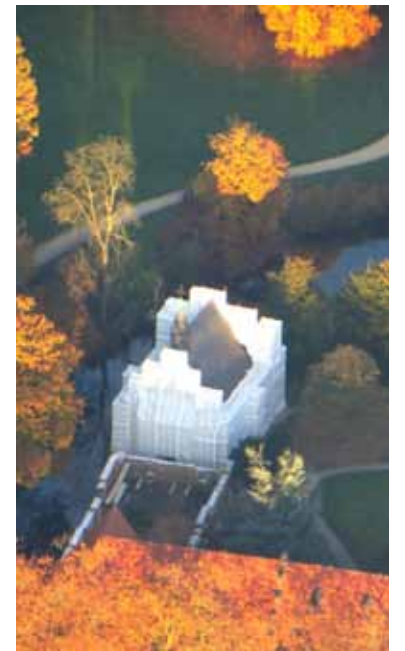
Auch dieses Bauprojekt der LWL-Klinik Herten macht Fortschritte: Die Kapelle am Schloss brauchte einen neuen Anstrich. Die Putzarbeiten wurden bereits ausgeführt, die Malerarbeiten können beginnen. Im Januar wird sie wieder in neuem Glanz erstrahlen – dann wieder unverhüllt.
